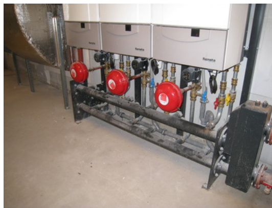
Ongeïsoleerde verdeler CV-ketels
